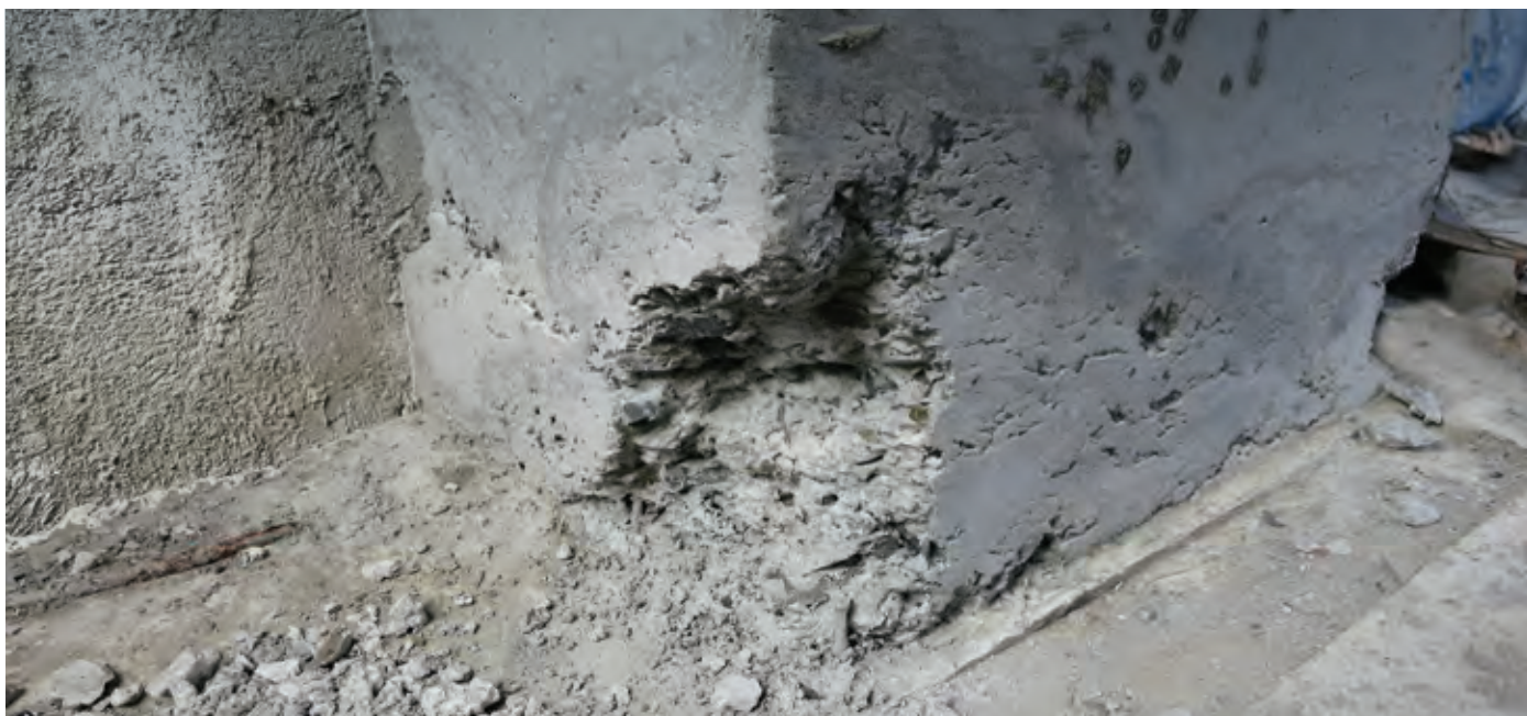
Дефекты бетона при бетонировании в зимний период, www.pinterest.com
