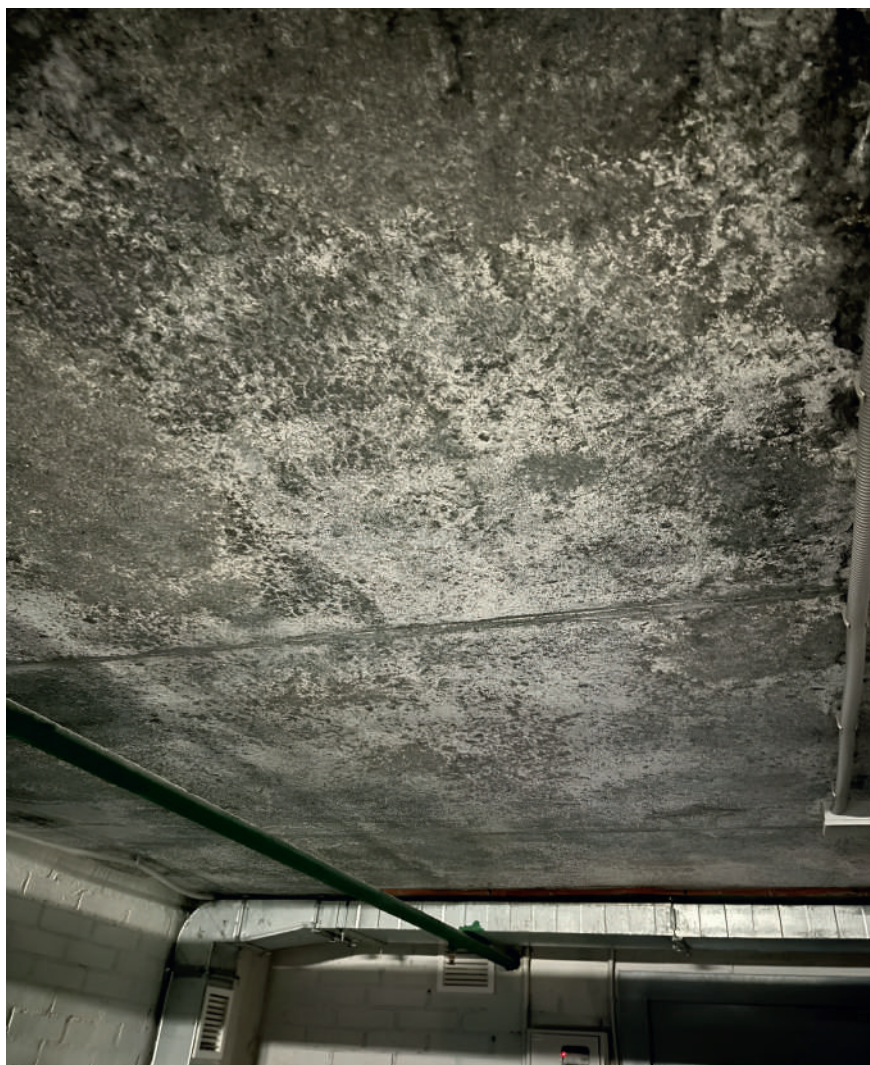
Капиллярная фильтрация воды через бетон
