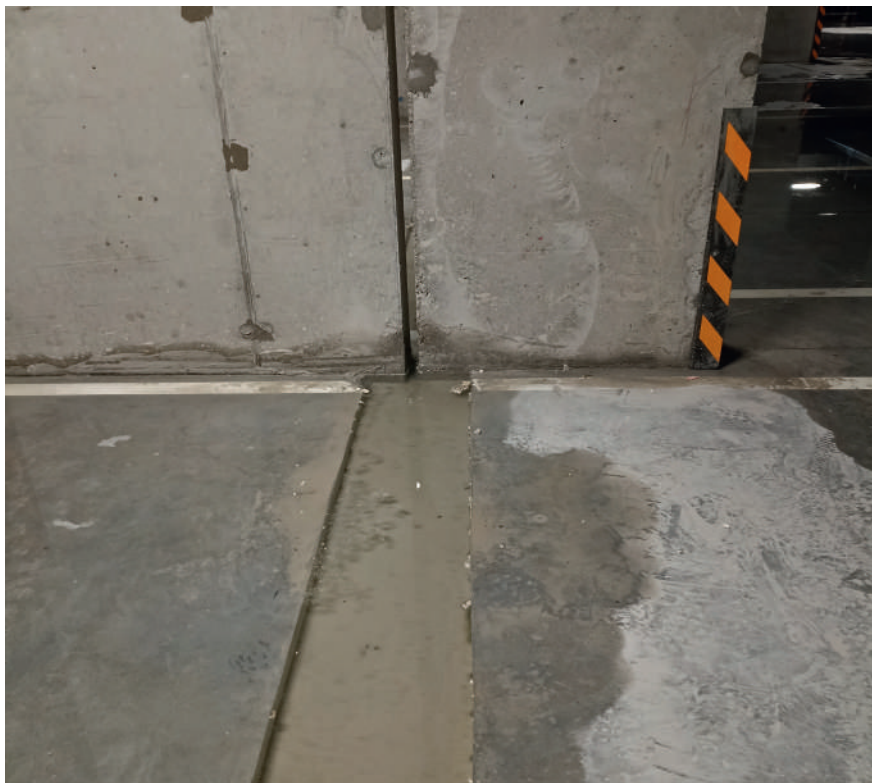
Протечки через деформационный шов
