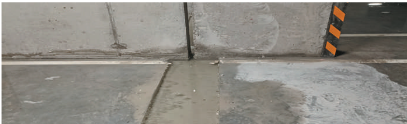
Рис. 6. Подтопление деформационного шва с гидрошпонкой
