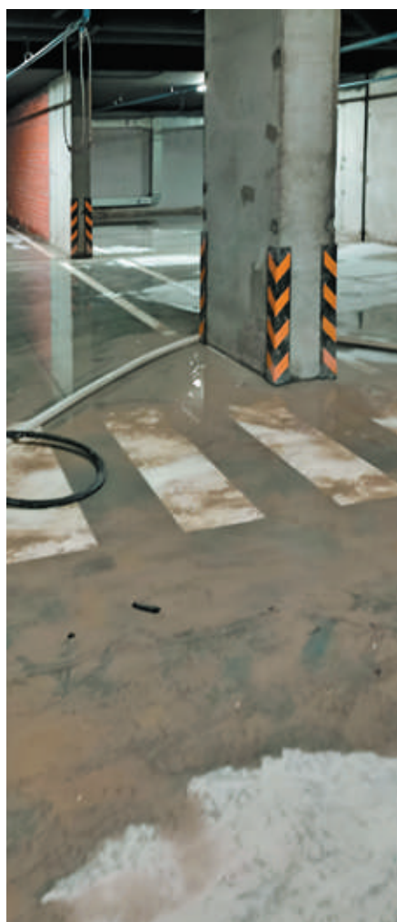
Рис.1. Подтопление паркинга со стандартной гидроизоляцией
