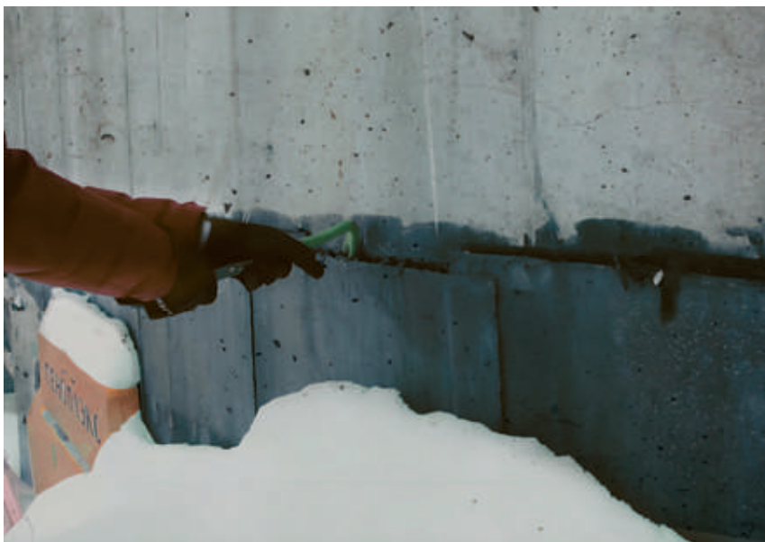
Рис. 2. Отслоение рулонной гидроизоляции с поверхности бетона
