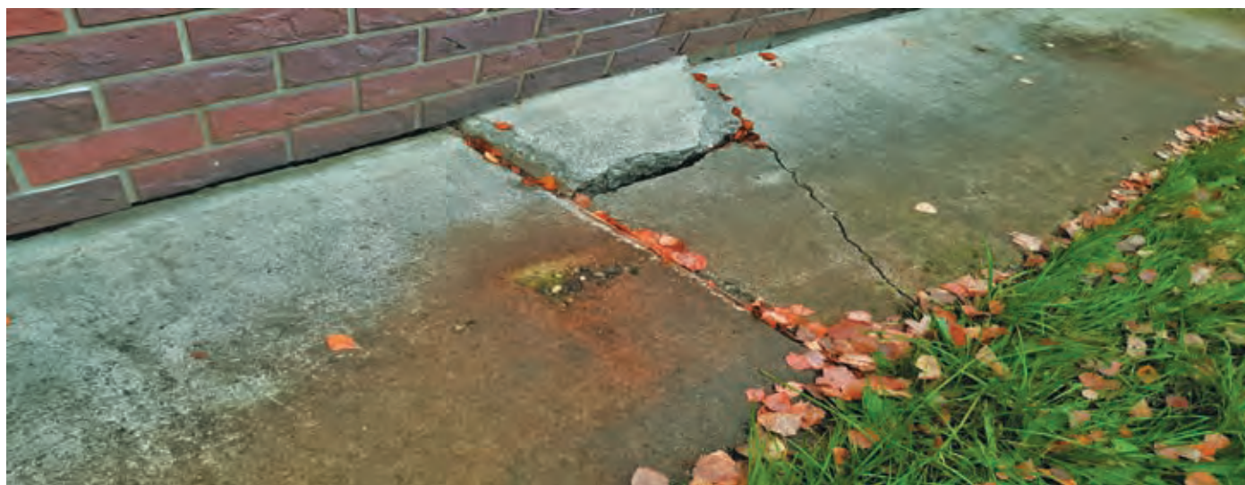
Пример разрушения отмостки загородного дома
